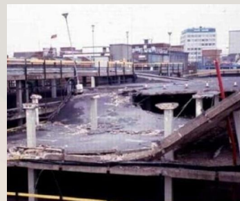
发生冲切破坏
