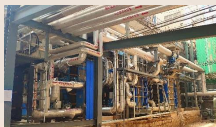
钛白粉、钢铁工艺余热利用系统
