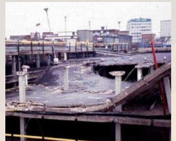
发生冲切破坏
