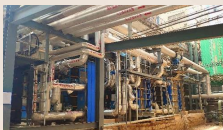
钛白粉、钢铁工艺余热利用系统
