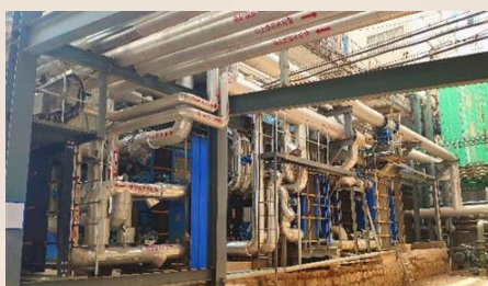
钛白粉、钢铁工艺余热利用系统
